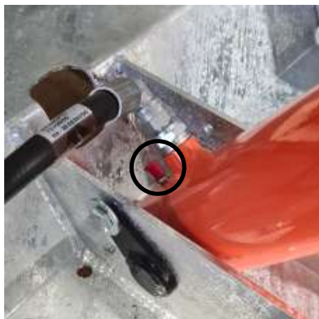
Ariete hidráulico (extremo inferior)
